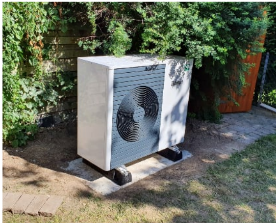
Da steht sie endlich: die Wärmepumpe.
